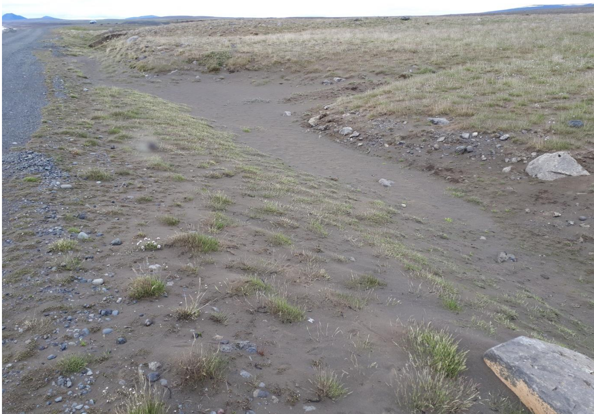
Mynd 5. Sandskafl í lægð við veginn, horft til norðurs.
